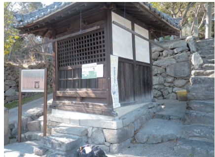
図4-2：傾いた石積みの土台とそれを修復した跡がある峠八幡神社の下の松谷御堂。
