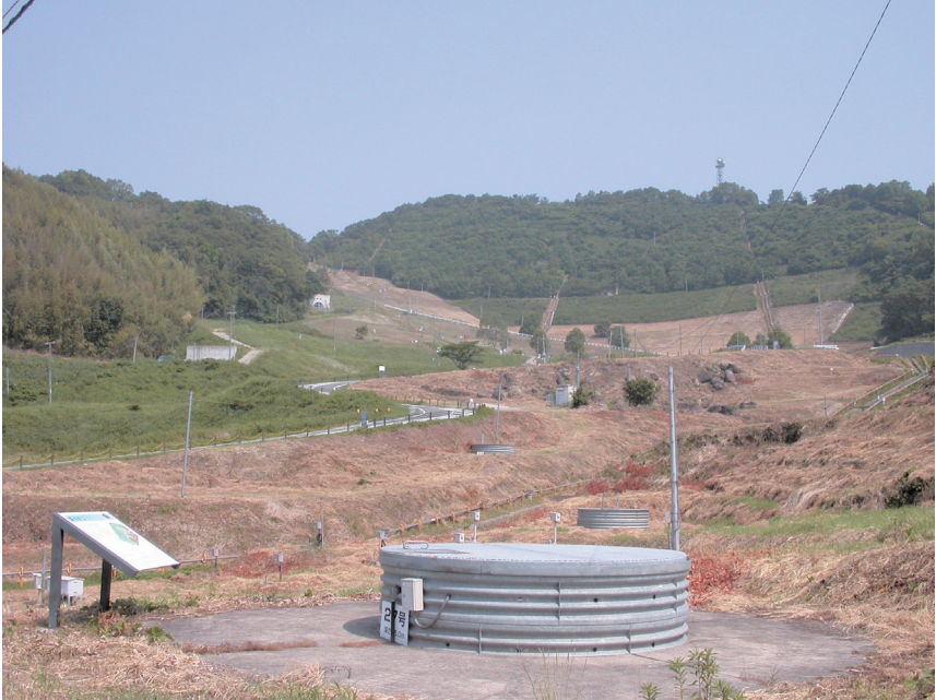
図4-1：亀の瀬の地すべり地域。地すべり対策工事によって大量の土砂が運び出され、元々の山の形は失われている。大きなパイプは集水井で、地すべりの原因となる地下水を集めて排水している。
